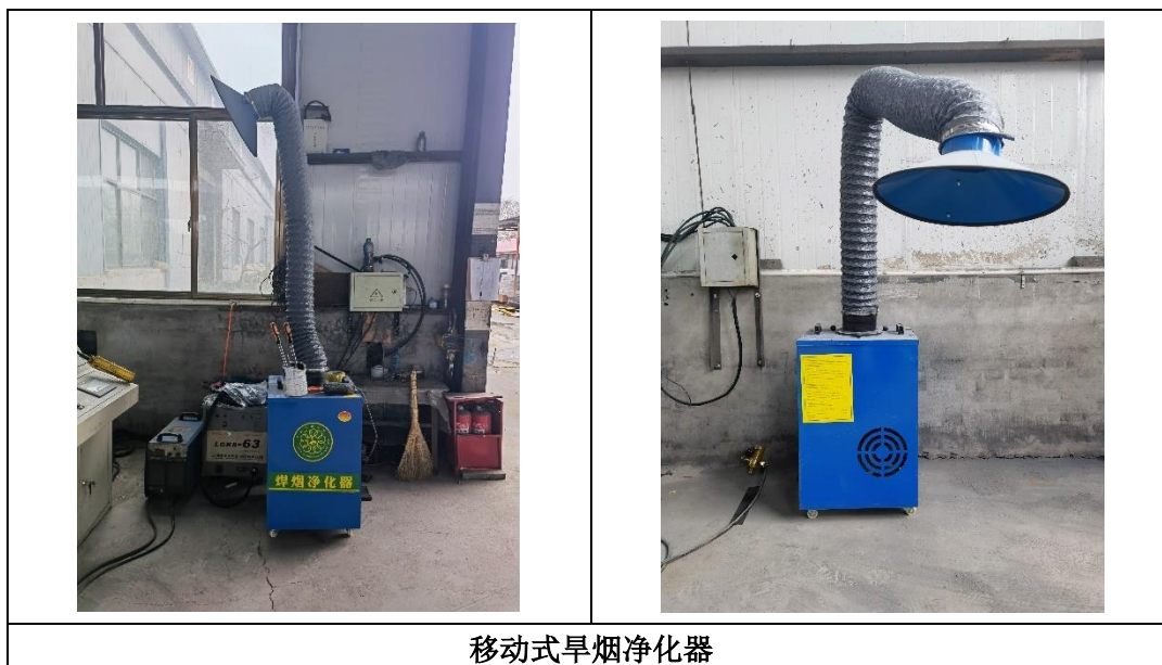
图 3-1 废气治理措施照片
