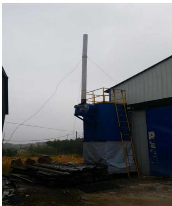
图 4-1: 静态膨胀剂研磨工序废气: 布袋除尘器+15m 排气筒
